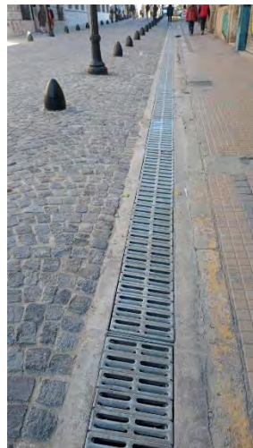
Figura 6. Sistema de captación Tipo Acequia con rejilla (canal lateral). Calle Bolívar 1000
