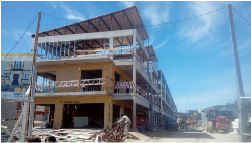
Figura 1. Vista general del conjunto habitacional en donde puede observarse el grado de avance actual, los paneles interiores y parte de los paneles exteriores a los que se les colocará aislante y tendrán como revestimiento la chapa acanalada azul. La recova de planta baja es por partes pública, y por otras privada y de las viviendas.
